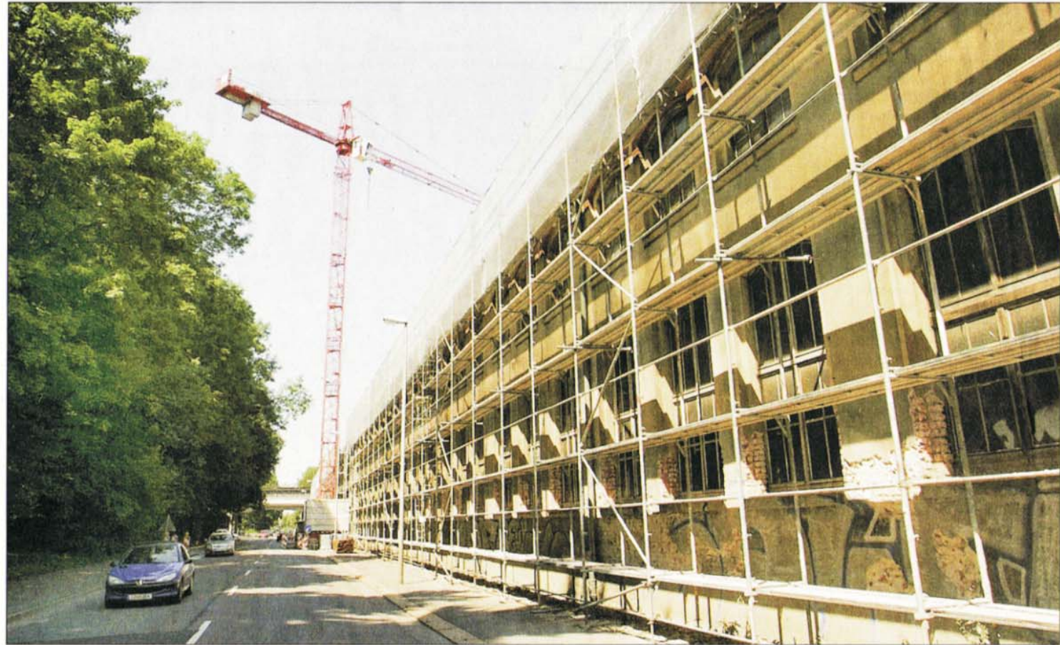
Die meterlange Fassade der Gießerei an der Schönherrstraße im Norden der Stadt wird saniert.
